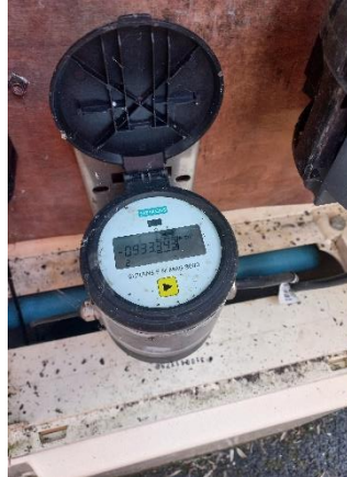
Compteur d'achat d'eau à Vendée Eau à Hucheloup à Gétigné
