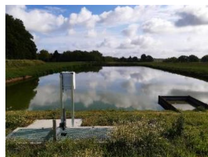
Canal de comptage sur la station d'épuration de La Brebionnière
